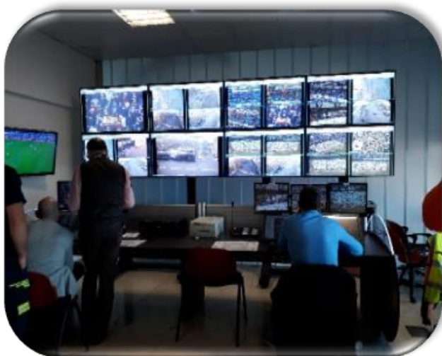
Figura 68: Circuitos cerrados de televisión
