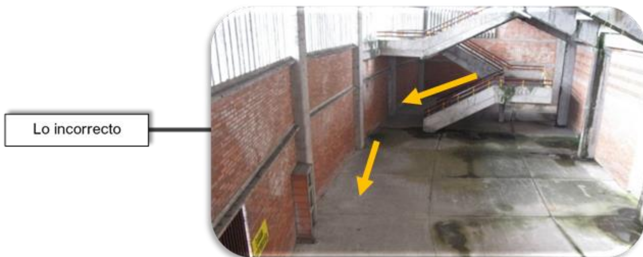
Figura 30: Escalera de evacuación que genera cambios de dirección
